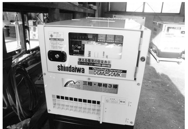
非常用発電機（移動式）
